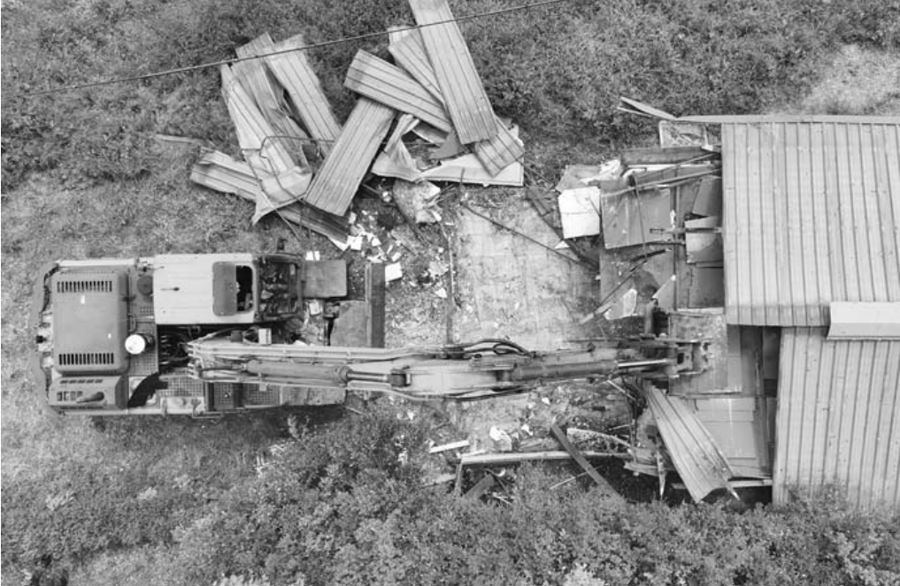
영산강 불법 점용 시설물 철거 광주 광산구가 국가하천인 영산강 둔치에 불법 설치된 조립식 건축물 1동에 대한 강제 철거에 들어간 30일 굴삭기 등 철거 장비와 전문 인력을 투입해 건축물을 해체하고 있다. <광주광산구 제공>
