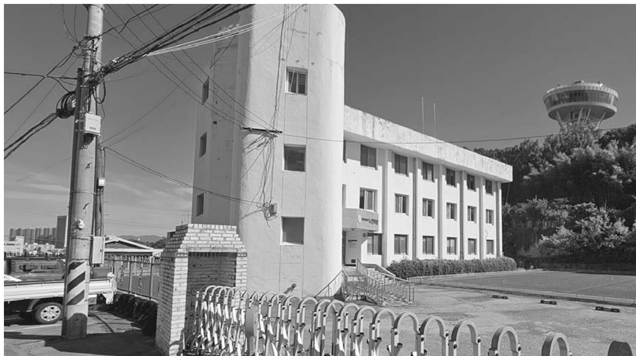
26일 광주 남구 제중로 92 소재의 전 광주시노인회관. 수년째 공실 상태로 건물 곳곳의 페인트가 벗겨지고 균열이 가 있으나 일부 학생들이 무단 침입하는 하연 인근에서 어르신들이 게이트를 치기도 해 안전사고 등의 우려가 일고 있다. /주성학 기자
