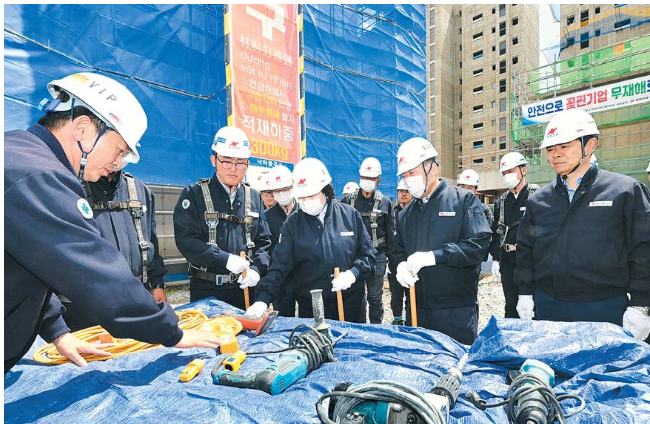
고품질·무하자 완벽시공을 위해 안전 지도점검에 나선 마형렬 남양건설 회장과 김광아 남진건설 사장 등 남양건설 관련 임원진들이 24일 담양센터파크 지역주택조합아파트 신축공사 현장을 방문, 작업장 내 안전관리 실태 등을 점검하고 있다. /김영근기자
