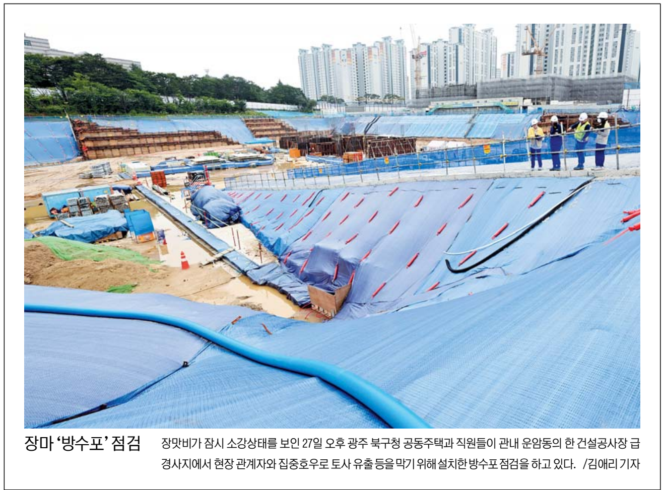
장마 '방수포' 점검 정마비가 잠시 소강상태를 보던 27일 오후 광주 북구청 공동주택과 직원들이 관내 운영동의 한 건설공사장 급경사지에서 현장 관계자와 집중호우로 토사 유출 등을 막기 위해 설치한 방수포 점검을 하고 있다. /김에리기자
