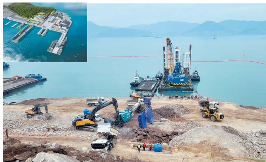
해양경찰청이 오는 2025년 상반기 준공을 목표로 해양경찰 서부정비창 신설사업을 진행하고 있다. 사진은 서부정비창 조감도(위), 기초준설 현장(아래). (해양경찰청 제공)
