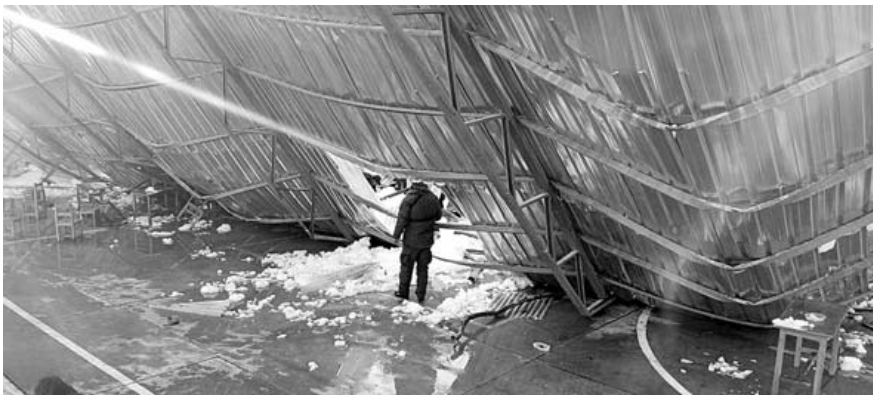
볼리비아 학교 졸업식장 지붕 붕괴 사고 현장.
