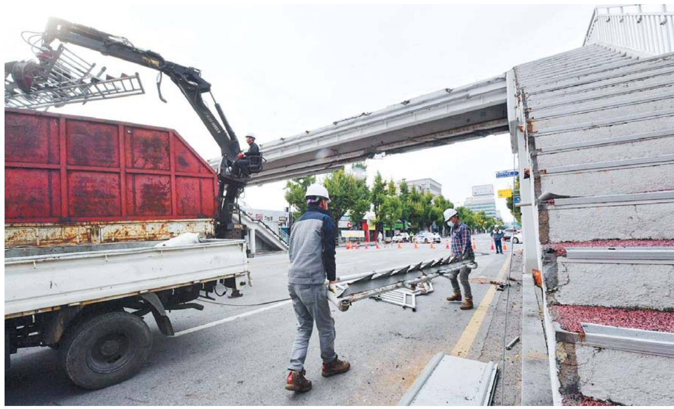
수창초교 앞 육교 본격 철거 광주 북구 북동 수창초등학교 앞 육교의 철거가 본격적으로 시작된 20일 오후 관계자들이 주요 구조를 해체 작업을 하고 있다. 북구는 사고로 붕괴 위험성이 있는 육교를 이날 오후부터 해체 작업에 돌입, 21일까지 모두 철거할 계획이다. 한편 1972년 12월 29일 설치해 48년 된 이 육교는 지난 18일 오전 짐게 차(너클 크레인)가 육교 교각과 충돌하면서 파손됐다. /김애리기자
