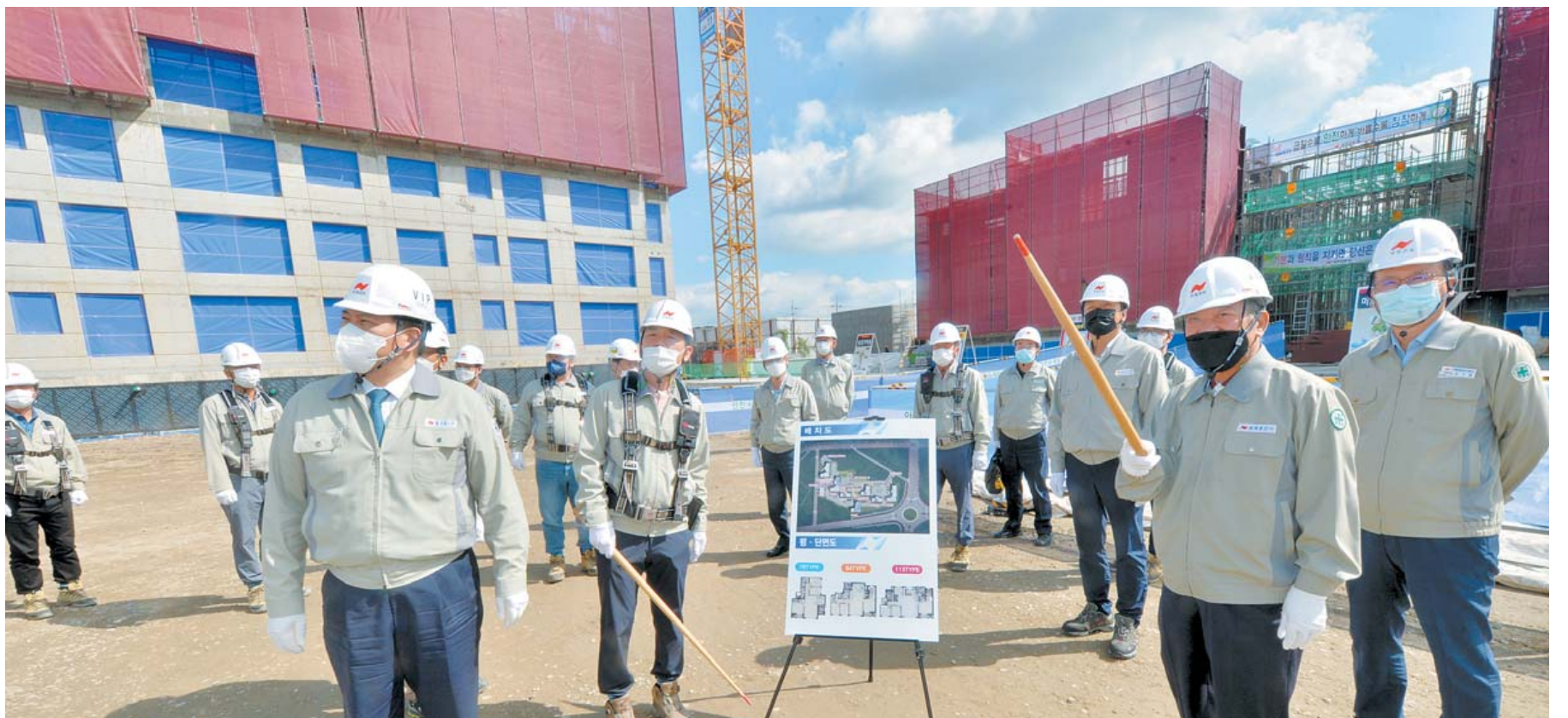
고품질·무하자 완벽시공을 위해 안전 지도점검에 나선 남양건설(주) 마형렬 회장과 마찬호 사장 등 임원진이 14일 전북 순창 남양휴튼 아파트 신축공사 현장 방문, 철저한 안전관리와 진행상황을 점검하고 있다. /김영근기자
